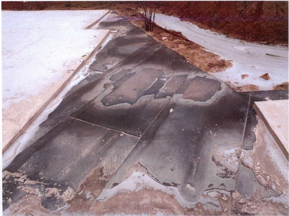
Фото № 15. Нарушенная гидроизоляция в зоне секции 3
