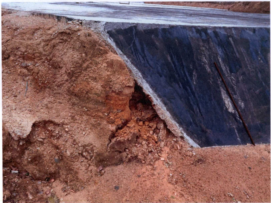
Фото № 18. Вымывание грунта из под бетонной подготовки в зоне секций 1 и 2
