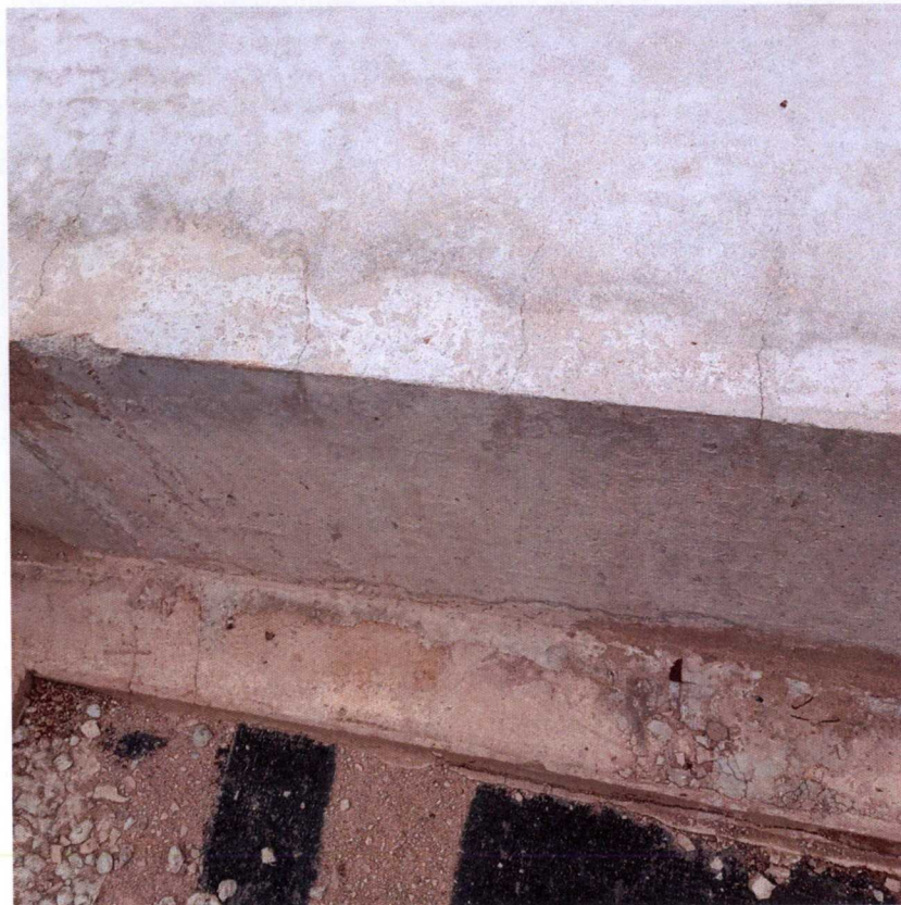
Фото № 6. Вертикальные трещины в монолитной железобетонной фундаментной плите секции 8 раскрытием до 0,5 мм.
