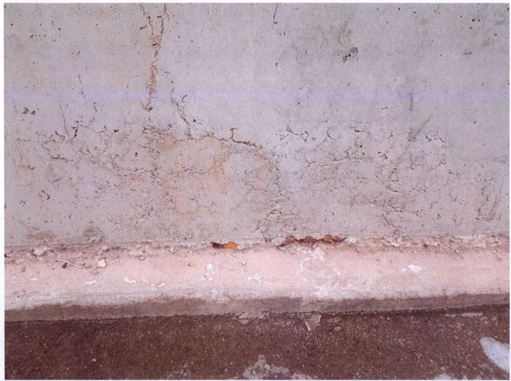
Фото № 9. Участок плохо провибрированного бетона фундаментной плиты в зоне секции 6.
