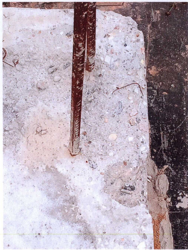
Фото № 10. Выветривание бетона в фундаментной плите в зоне секции 5
