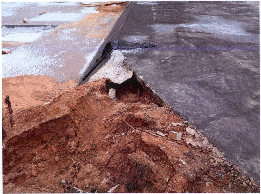
Фото № 17. Вымывание грунта из-под бетонной подготовки. Воздушная пазуха между грунтом и бетонной подготовкой в зоне перепада высот секции 2 и 1 высотой 30 см.
