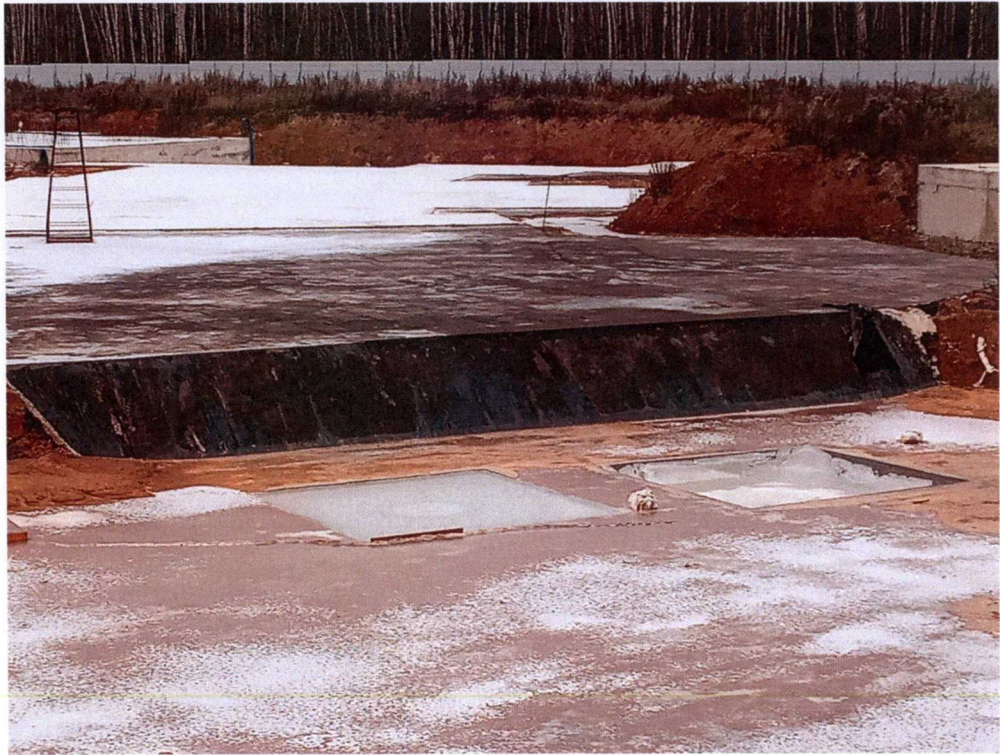
Фото № 16. Перепад высот в зоне секций 1,2
