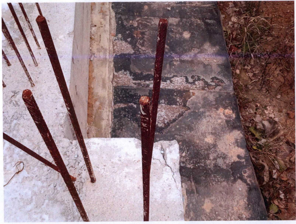
Фото № 11. Выветривание бетона в фундаментной плите в зоне секции 5
