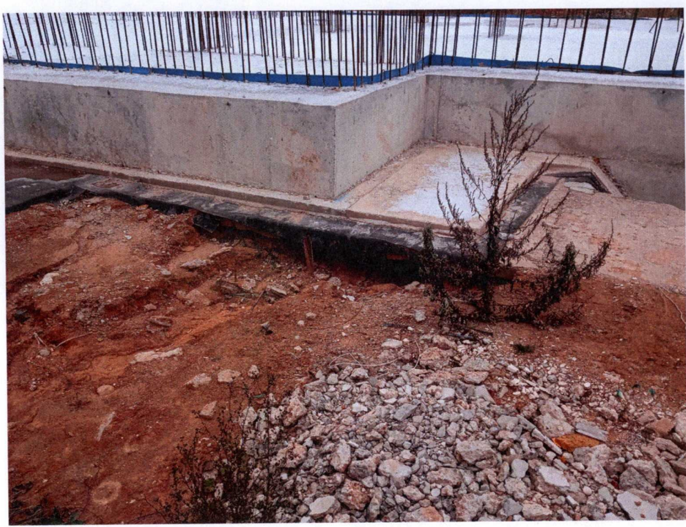
Фото № 12. Вымывание грунта из-под подошвы бетонной подготовки в зоне секции 5
