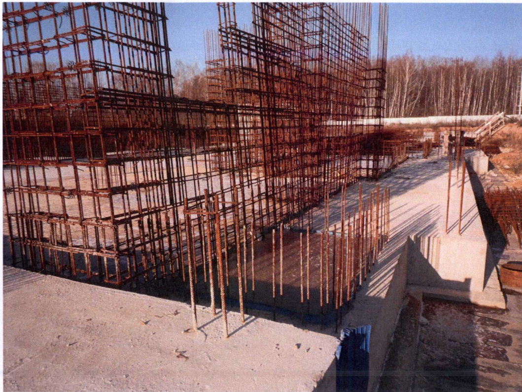
Фото № 7. Коррозия арматурного каркаса будущих стен в зоне секции 5.
